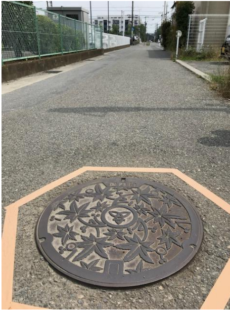
段差補修前（段差最大2cm）
